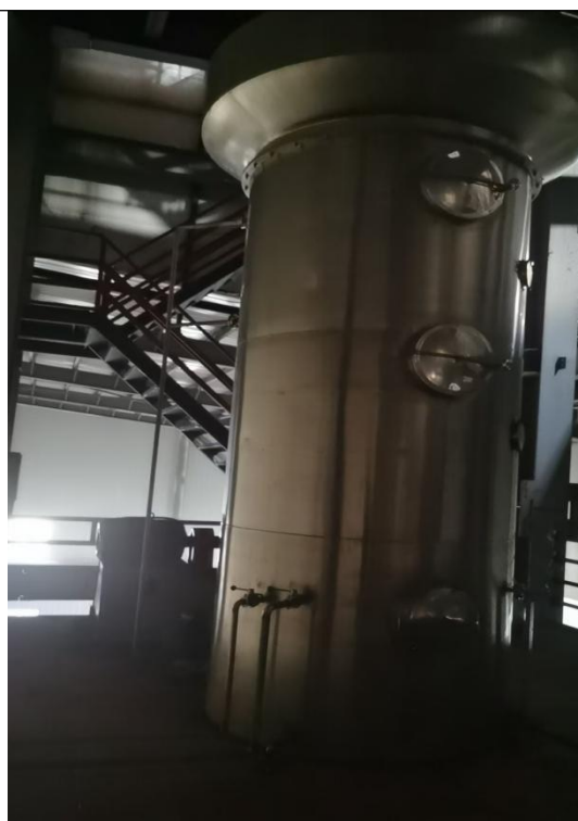
旋风除尘+水膜除尘器
