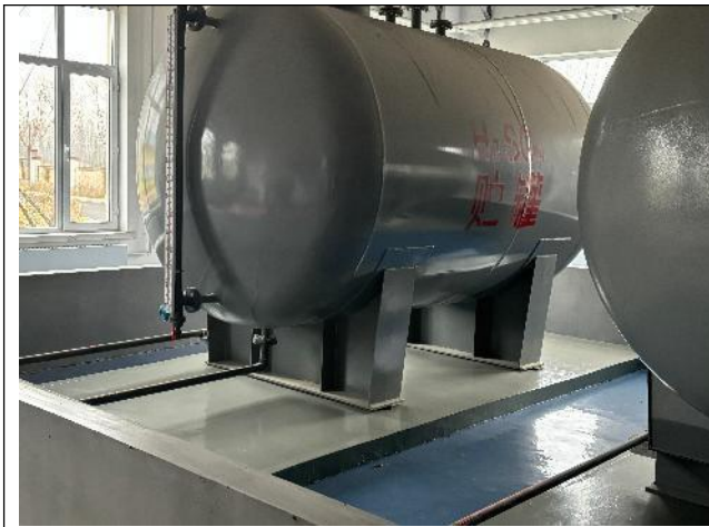
硫酸储罐及围堰
