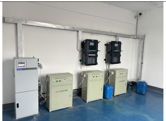
出水在线监测设备（位于污水厂一期工程内）
