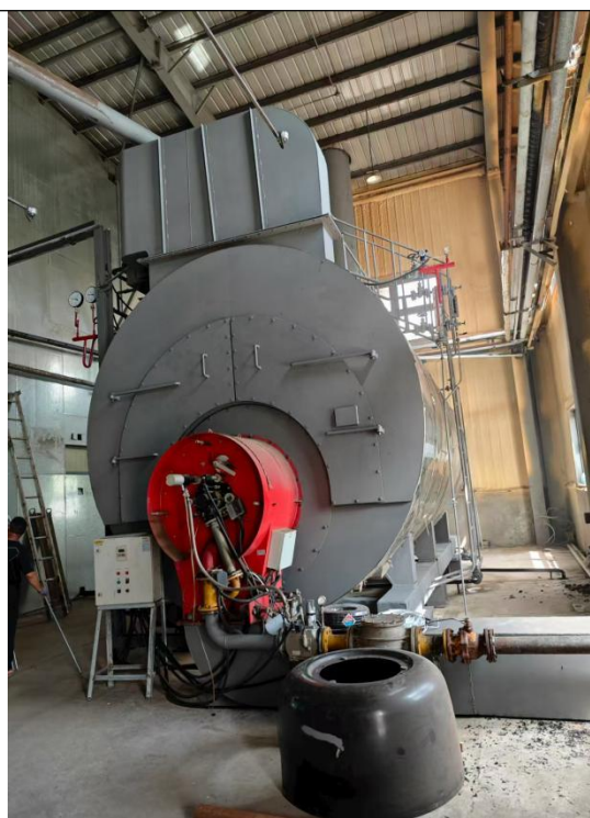
20t/h 天然气锅炉
